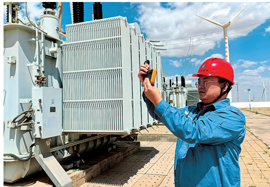
图为银星能源太阳山运维区域职工对升压站主变进行红外测温。
