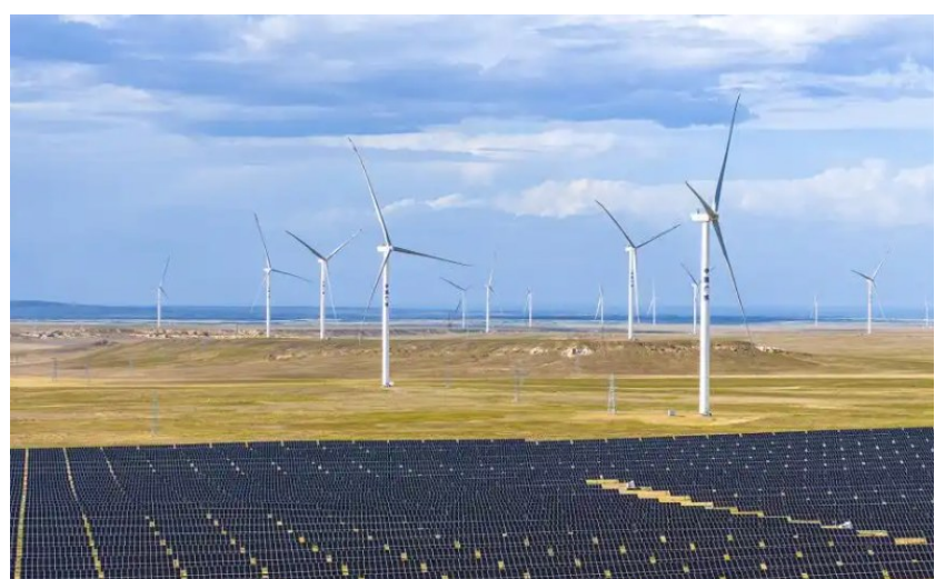
图为新疆阿勒泰地区吉木乃县50万千瓦风电项目配套输电线路建设现场。
